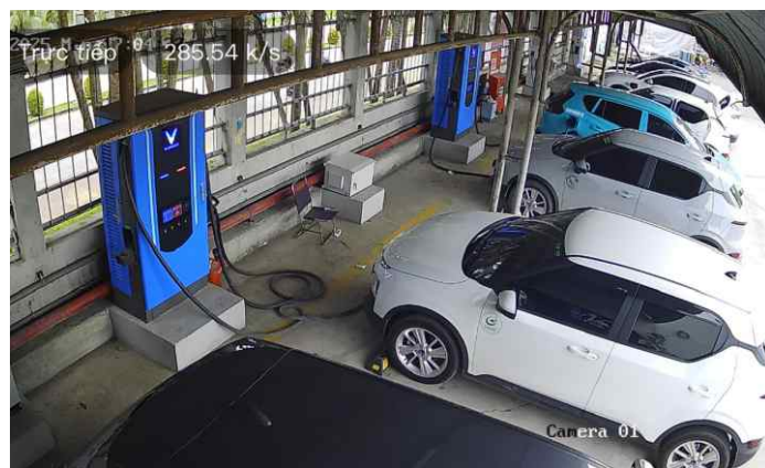
Trạm sạc Ô tô
